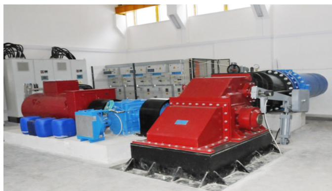
Εικόνα 6: Μικρός υδροηλεκτρικός σταθμός
