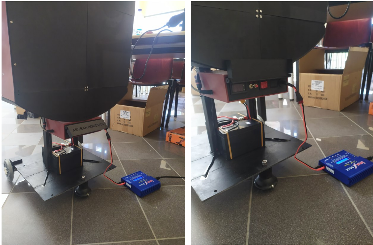
Εικόνα 22: Φόρτιση μπαταριών και πάνελ πίνακα ηλεκτρονικών
